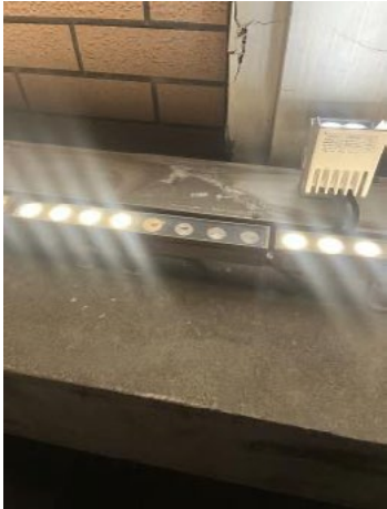
灯具线路板损坏
